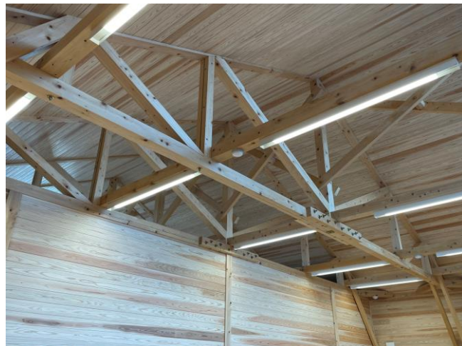
部材同士を三角形に組み合わせ強度を保つ 「木造合掌トラス（組み梁）構法」
